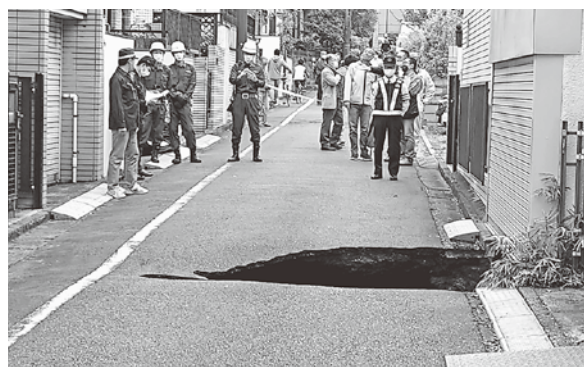
当時の陥没事故の状況(応急措置は終了しています)
